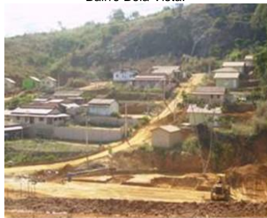
Figura 3.10: Área de desmoronamento – Bairro Bela Vista.
